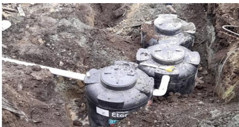
Figure 15: Foto biodigestor. Fuente: Registro de campo.
