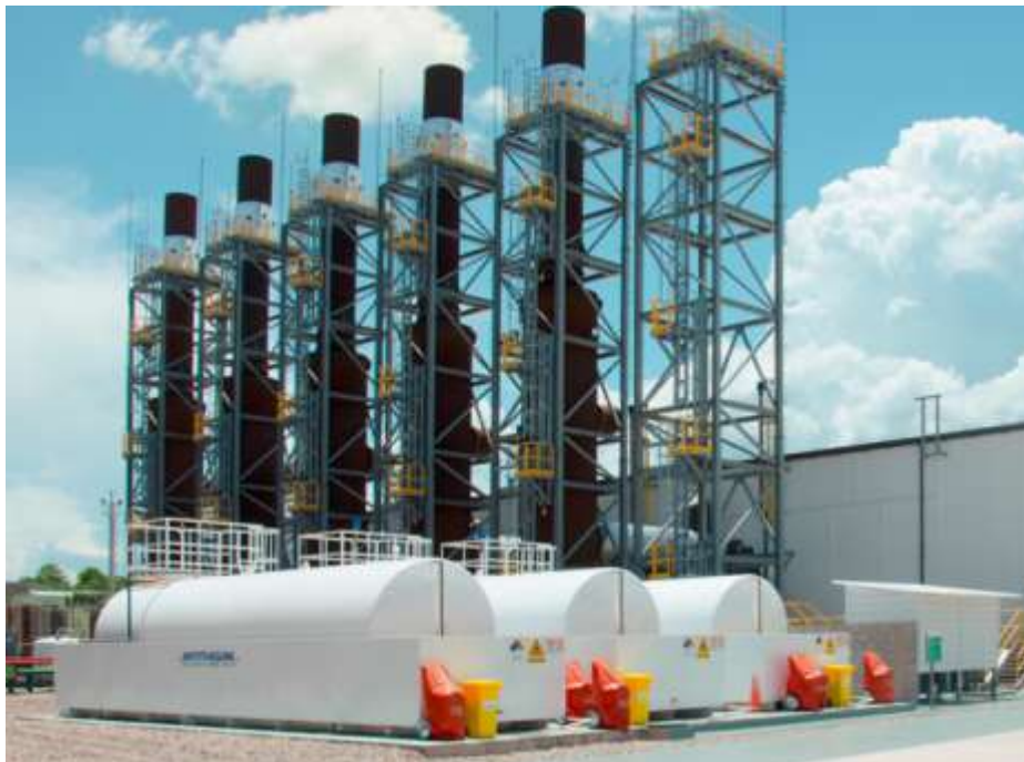
Imagen 17 - tanques de combustible y aceite contenidos en baterías
