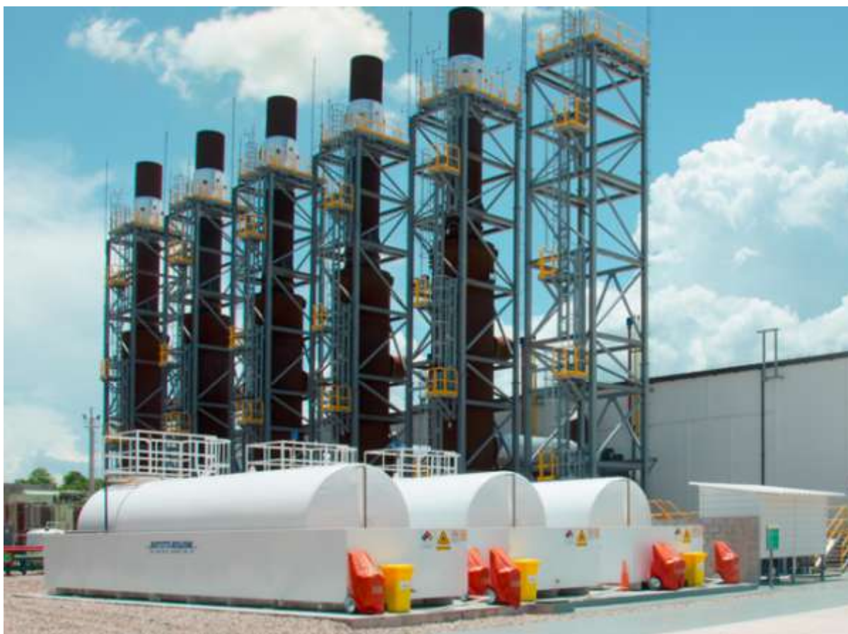
Imagen 21 - tanques de combustible y aceite contenidos en baterías
