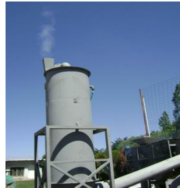
Figura I.63. Lavador de gases y salida de humos INTI
